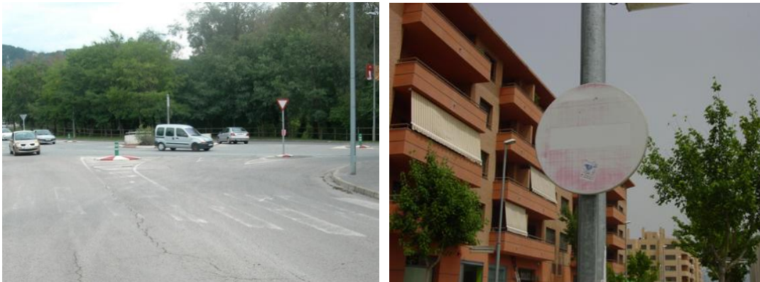
Imatge 69. Senyalització en estat deficient
