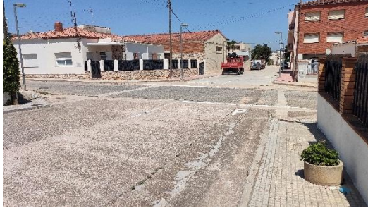
Imatge 23. Carrer Mossèn Onofre Català, falta de visibilitat en cruïlla, a més de falta de passos de vianants a tota la cruïlla.
