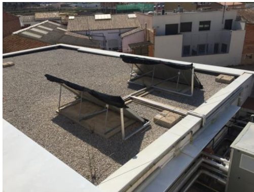
Figura 6. Instal·lació solar tèrmica
