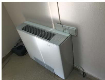
Figura 3. Unitats terminals fan-coils
