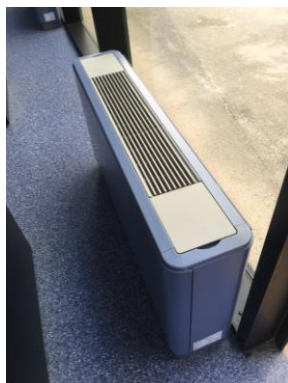
Figura 5. Unitat interior de climatització
