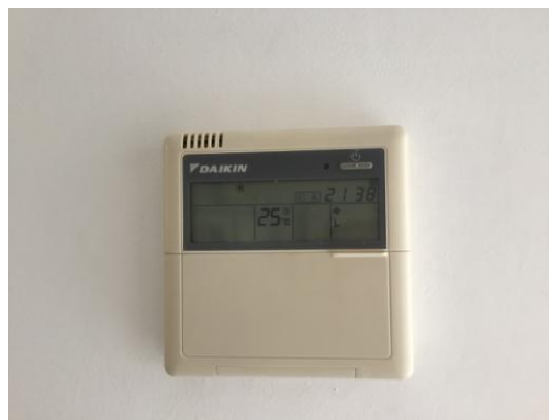
Figura 6. Termòstat de climatització
