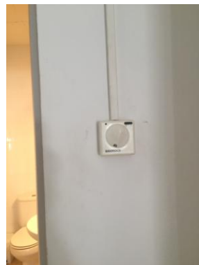
Figura 6. Termòstats de climatització
