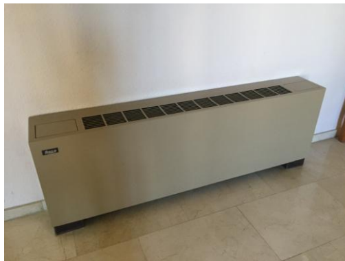
Figura 7. Unitats terminals fan-coils
