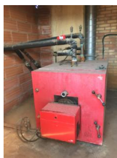
Figura 4. Caldera de gasoil
